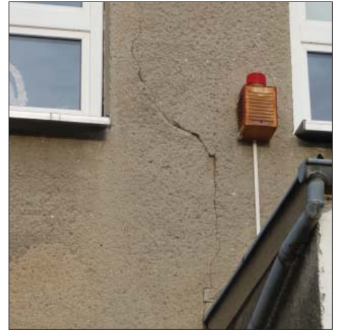
Gentz-Schule: Viele Risse, keine Wärmedämmung Foto: Jürgen Schubert
